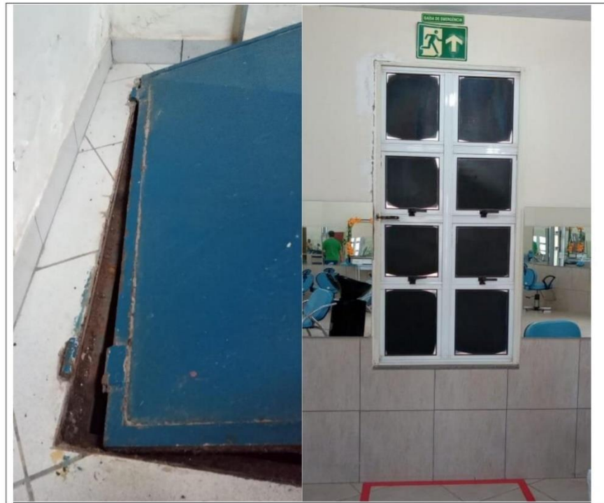
Fig 11. Troca de esquadrias portas do alçapão do reservatório e trocas de portas de saída de emergência e demais portas;
