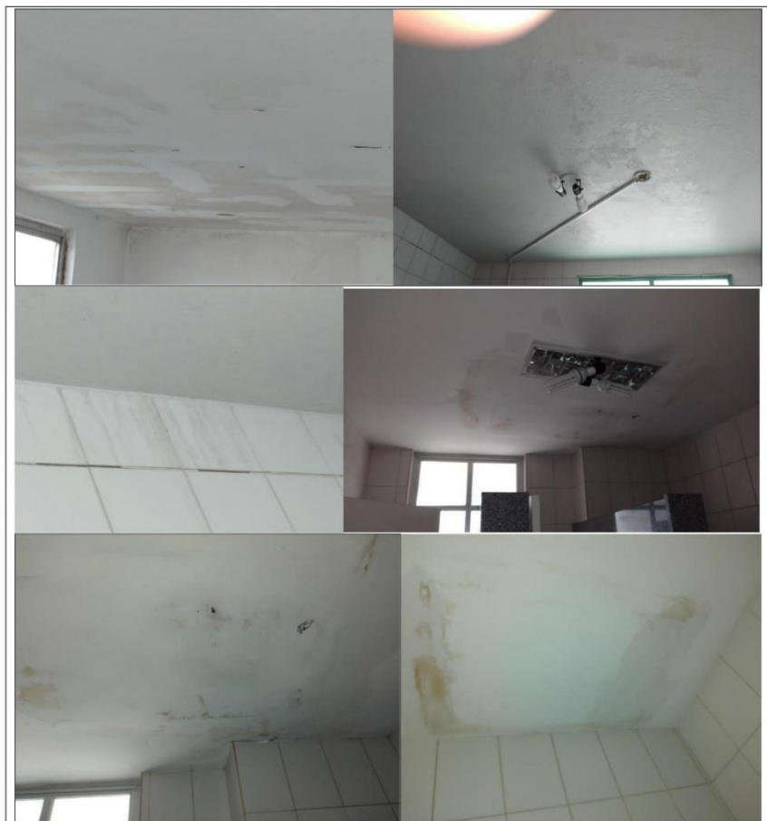
Fig 14. Forros de Gesso, PVC E Forro em Laje.
